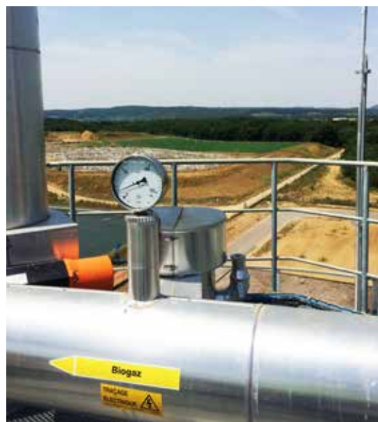
Le poste d'injection compte l'énergie, contrôle les caractéristiques du biométhane, l'odorise et l'injecte dans le réseau.
